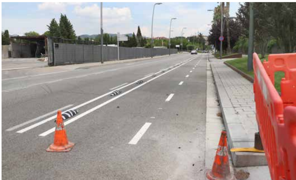
S'està construint un carril bici a la calçada per tenir més espai a les voreres. Quan entri en servei el nou carril ciclable, els vianants guanyaran més espai per anar per la vorera
