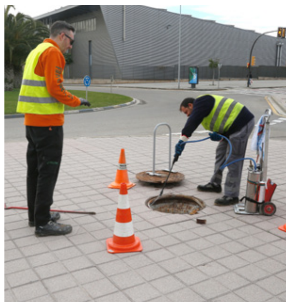
El tratamiento se aplica directamente en pozos y sumideros
