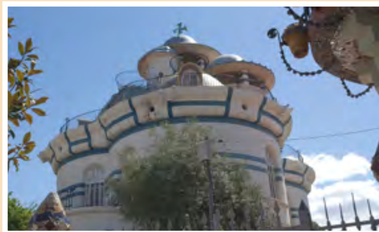
En l'àmbit de les inversions, es destinen 200.000 euros per a la millora d'alguns elements de la Torre de la Creu que, amb el temps, requereixen d'una renovació. És el cas de la fusteria exterior, ara en molt mal estat. Cal preservar un dels símbols del nostre patrimoni, joia del modernisme que genera interès a nivell internacional.
