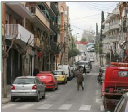
Remodelació dels carrers Jacint Verdaguer (a la foto), Sant Francesc d'Assís, Freres, Domènec, Font del Be i Llobregat
