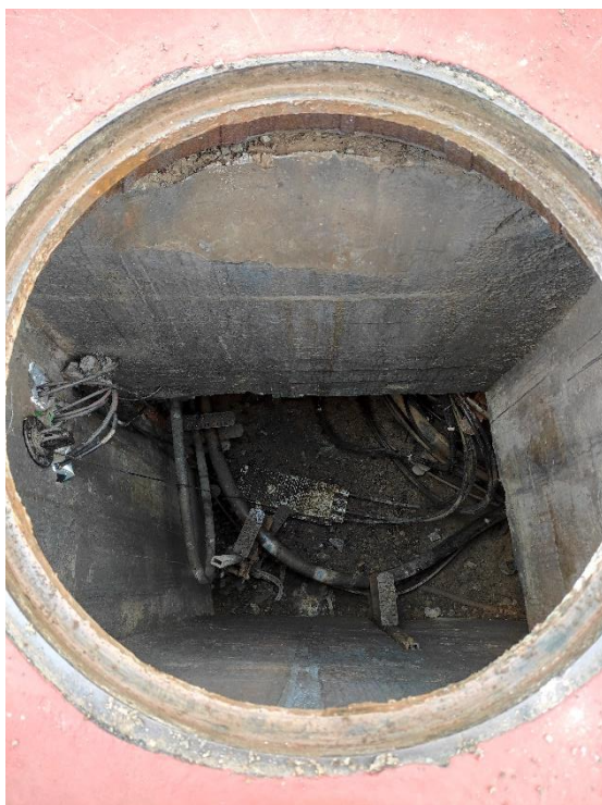
Figura 9. Vista interior de l'arqueta de Telefónica
