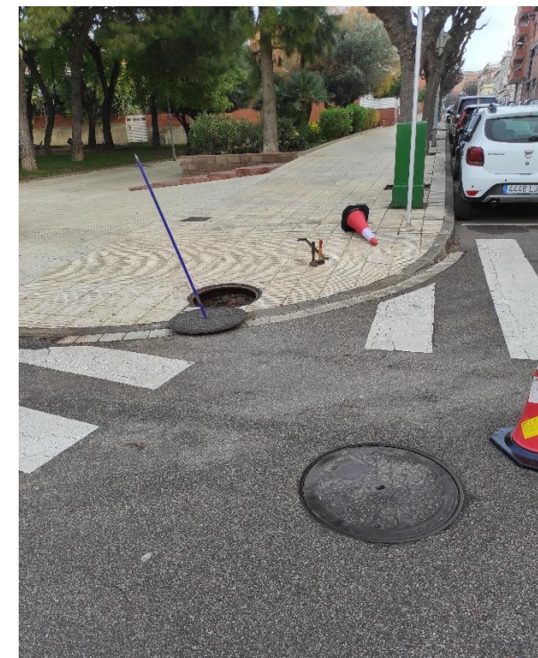
Figura 3. Pou de registre PR374 obert a la Riera d'en Nofre a l'altura del carrer Catalunya
