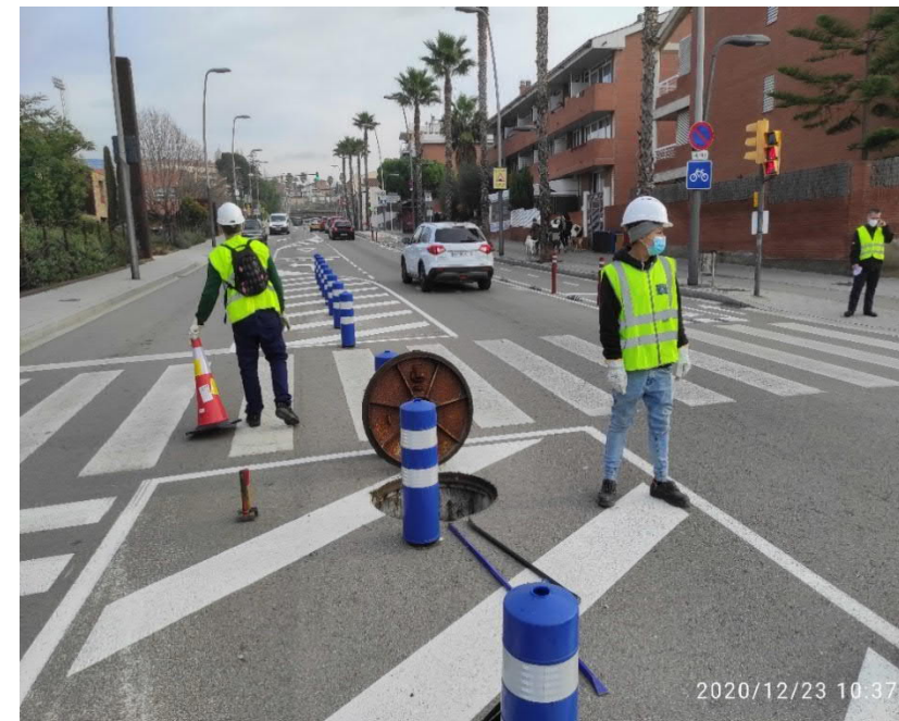
Figura 11 (esquerra). Inspecció de les connexions de la xarxa de sanejament al 2021 realitzada per TYP SA
