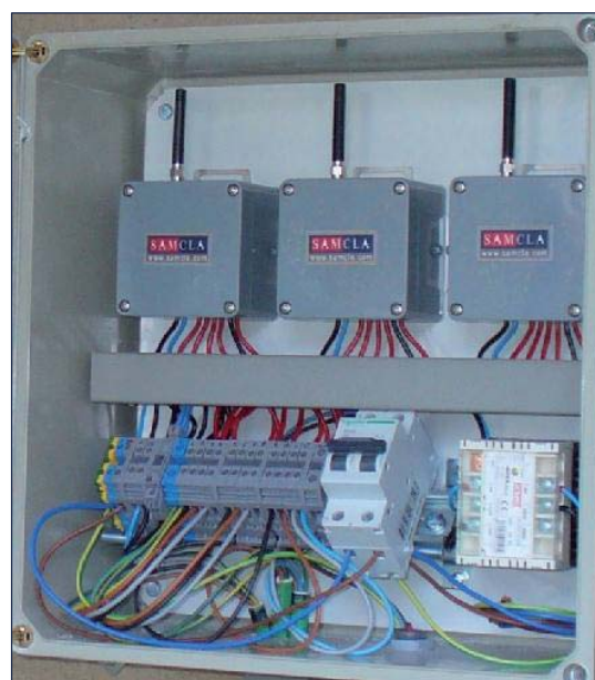
Armari per al control de 12 sectors
