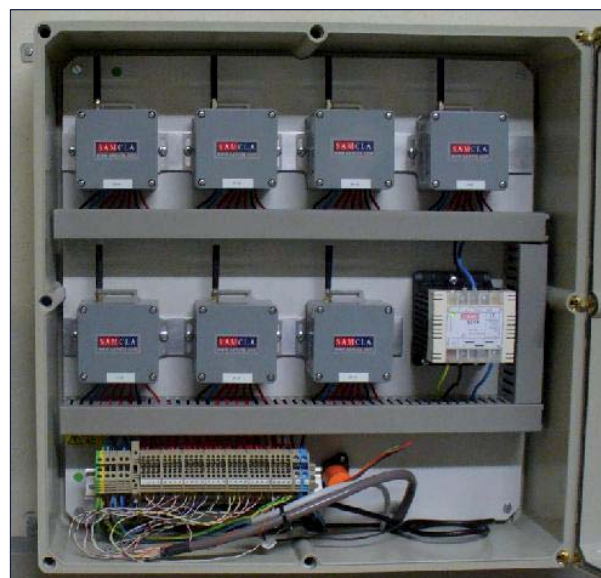
Armari per al control de 28 sectors
