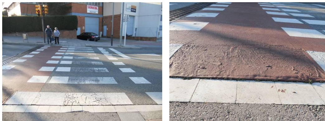
Fig. 17. Desperfecte quitrà. Av. de Barcelona amb av. de la Mare de Déu de Montserrat
