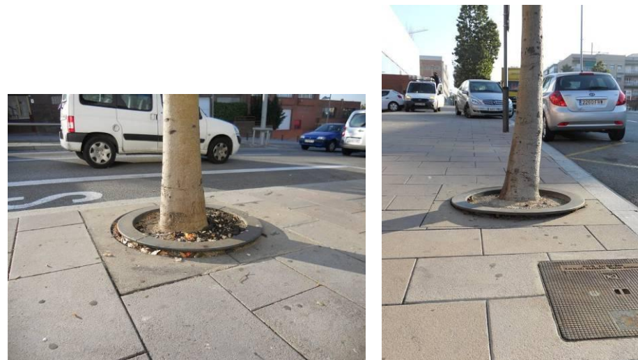
Fig. 19. Escocells aixecats. Av. de Barcelona amb av. de la Mare de Déu de Montserrat
