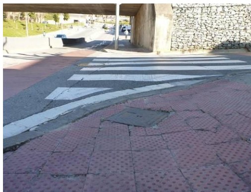
Fig. 14. Paviment en mal estat i tapa no enrasada. Creu d'en Muntaner amb c. del Ferrocarril
