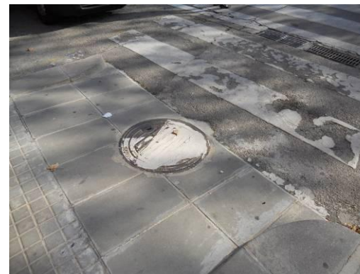
Fig. 11. Reixes i pas en mal estat. C. de Sant Martí de l'Erm amb Marquès Fig. 12. de Monistrol
