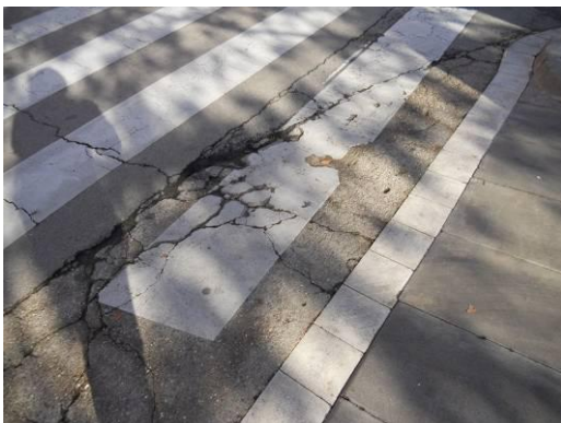
Fig. 10. Paviment en mal estat. C. de Fructuós Gelabert
