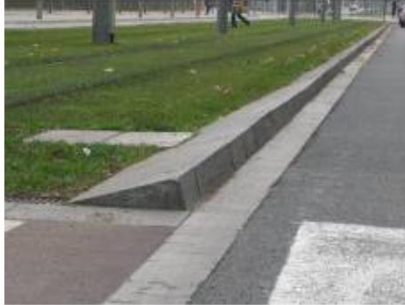
Fig. 66. Vorades amb arestes vives a les calçades situades als costats de les vies del Trambaix. Font: Baixbus
