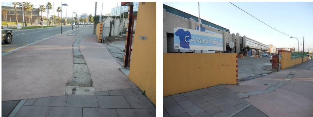
Fig. 16. Desperfecte vorera entrada Camimpress. Av. de Barcelona
