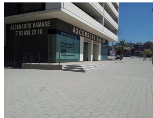
Fig. 9. Inexistència de barana a les escales. Av. de Barcelona, 111
