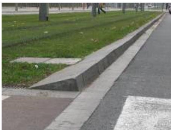
Fig. 69. Vorades amb arestes vives a les calçades situades als costats de les vies del Trambaix. Font: Baixbus
