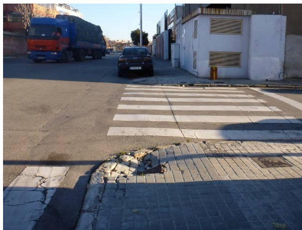
Fig. 37. Polígon industrial Fontsanta: vorera en mal estat, guals no adaptats, inexistència de pas de vianants i cotxes estacionats sobre la vorera.
