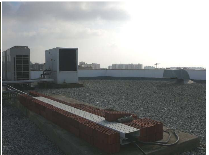
Figura 4. Coberta amb equips del sistema de climatització centralitzat.
