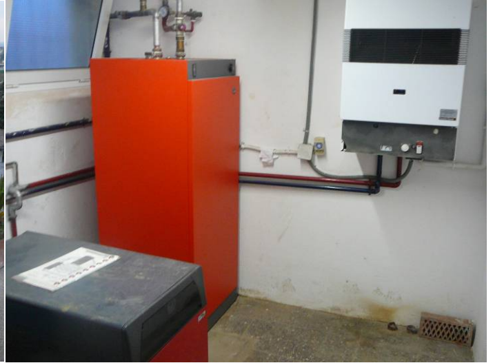
Figura 2. Sala de calderes.
