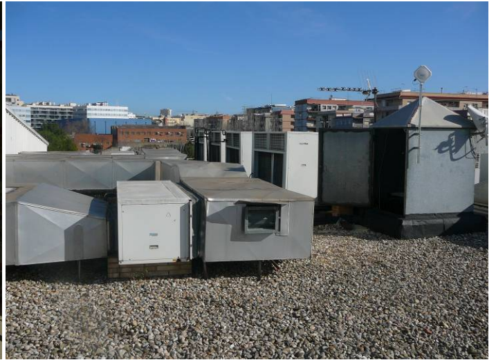
Figura 2. Equips del sistema de climatització centralitzada, instal·lats a la coberta.
