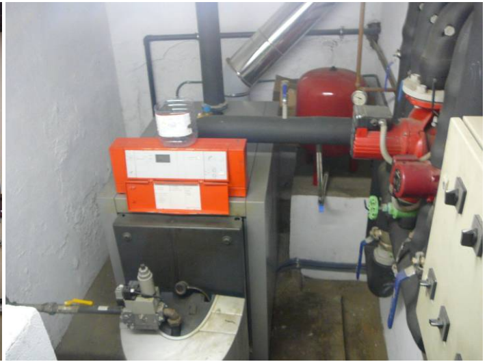
Figura 2. Sala de caldera i sistema de distribució.
