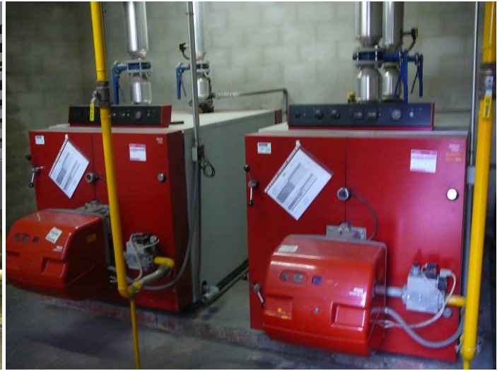
Figura 2. Sala de calderes.
