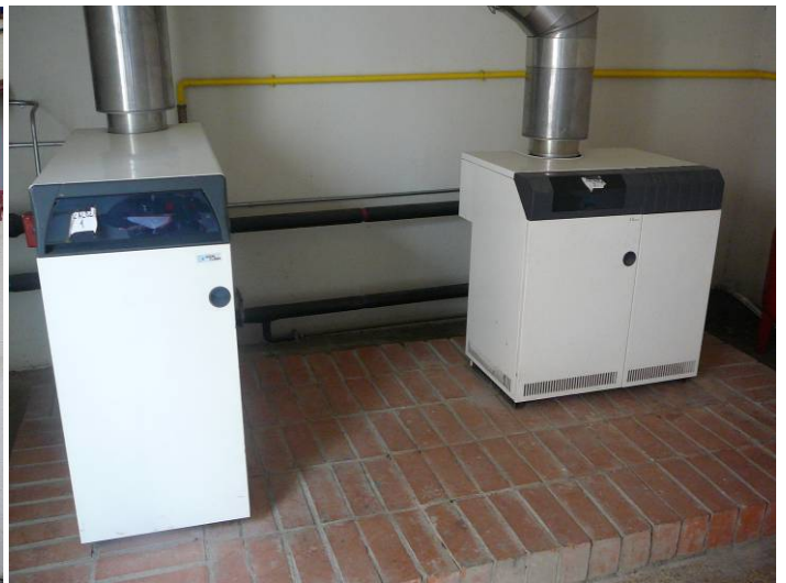
Figura 2. Sala de calderes.
