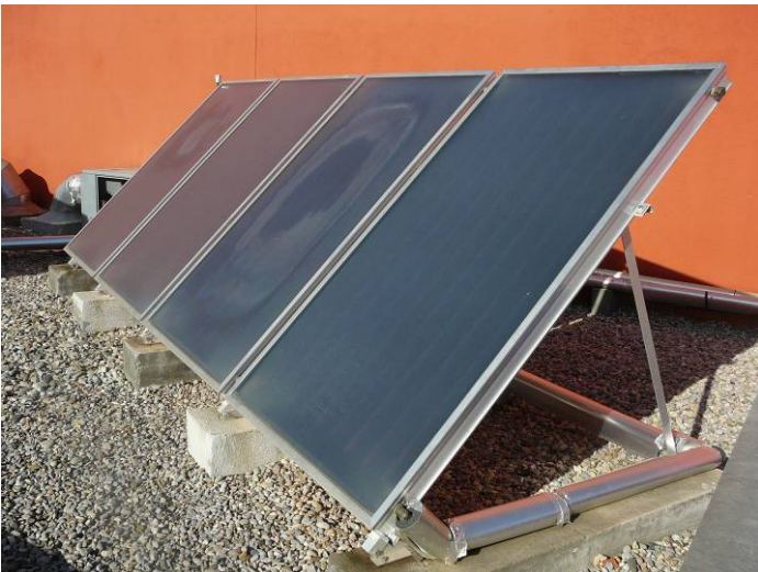
Figura 3. Sistema solar tèrmic per a la generació d'ACS situat a la coberta.
